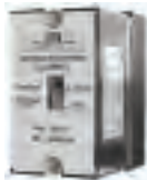
Реле настінний монтаж (на місці)
